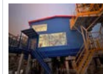
Вторая котельная для теплоснабжения завода «Арктик СПГ-2», ЯНАО, Гыданский п-ов
