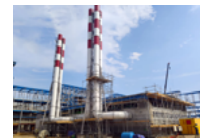
Запуск БМК, 56 МВт Дальневосточный ФО, Амурский газоперерабатывающий завод
