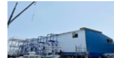
5 объект за полярным кругом, 40 МВт Котельная для завода по производ- ству сжиженного природного газа «Арктик СПГ-2», ЯНАО, Гыданский п-ов
